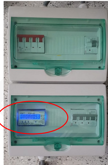
Nieuwe 400V kWh meter onder de bestaande 400V
