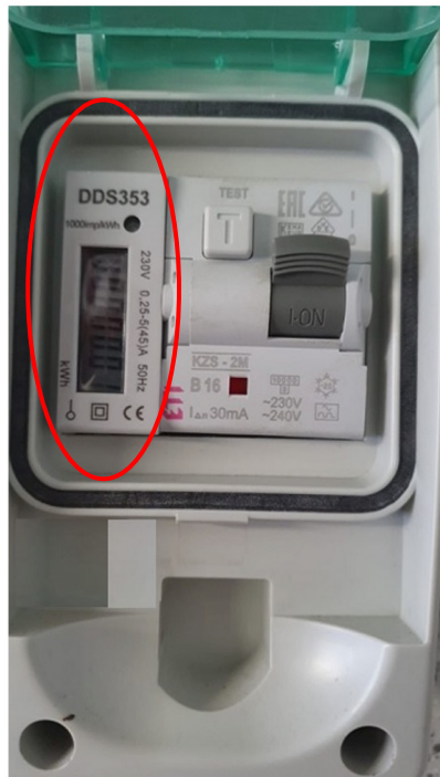
230V kWh meter in de omkasting van de aardelekschakelaar
